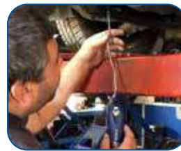
Fuga en eje de compresor.
