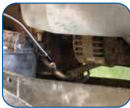
Fuga en toma de baja presión.
