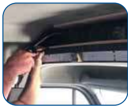
Fuga en evaporador de ambulancia.
